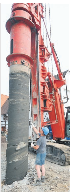
Das Bohrrohr aus Stahl, in dem der Meißelkopf kreist, wird für die nächste Bohrung vorbereitet.
