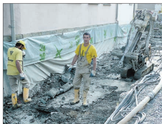
Die große Schlammsschlacht II: Da wo früher der Soestbach floss, gibt es jetzt eine Arbeitsfläche für die „Impfkolonne“. Ein Schneidbohrer frisst sich bis zu sechs Meter unter die Hausfundamente. Anschließend wird unter hohem Druck ein Spezialbeton in den Boden gepresst, der das Fundament sichert und außerdem tiefer gründet.
